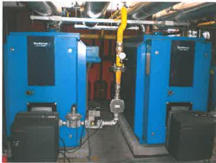
Calderas de la Sede Central
